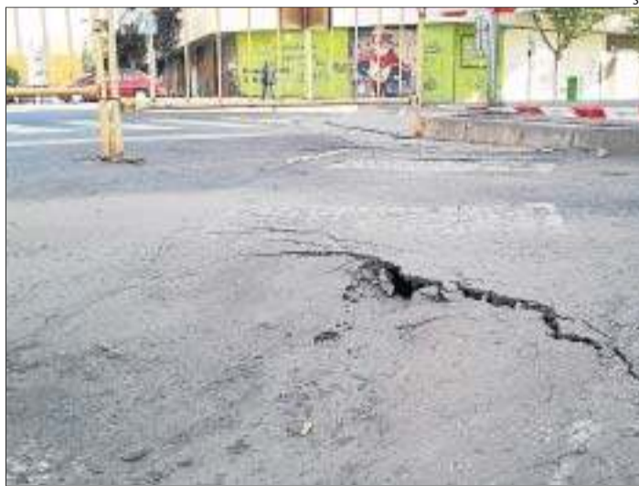
Clot a Roger de Llúria ■ La calçada al carrer Roger de Llúria de Pardinyes ha registrat un petit enfonsament, que no afecta la circulació al ser prop de la vorera.
